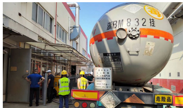
浙江冷食下沙工厂实施制冷系统无氨化改造，有效降低生产生活安全风险
